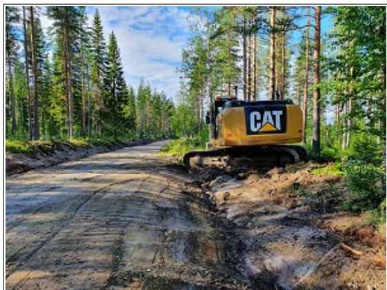
Fig. 96a. Foto: Gunnar Odell, 2020. ”Sörsivägen” reparerades år 2020. Här ca 240 m S om Bastuträsk 320. Fotoriktning mot NNV.
